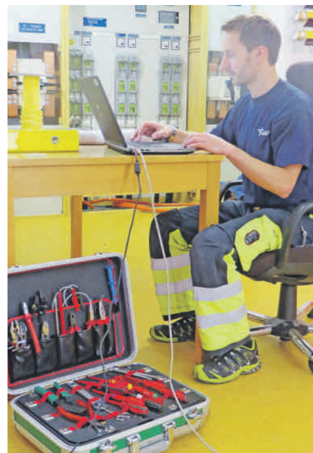
Neue Trafostationen und ein überarbeitetes Dispositiv sorgen für ein funktionierendes Strommanagement. Foto: St. Moritz Energie
