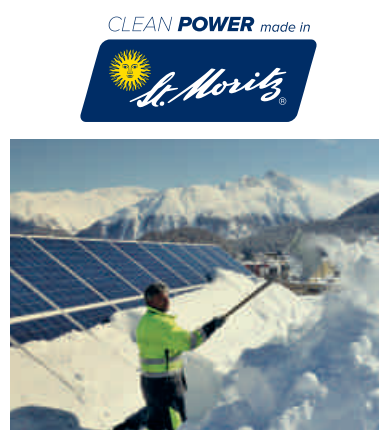
Der Ausbau der Solarenergie bedeutet auch einen steigenden Aufwand im Unterhalt der Anlagen.
