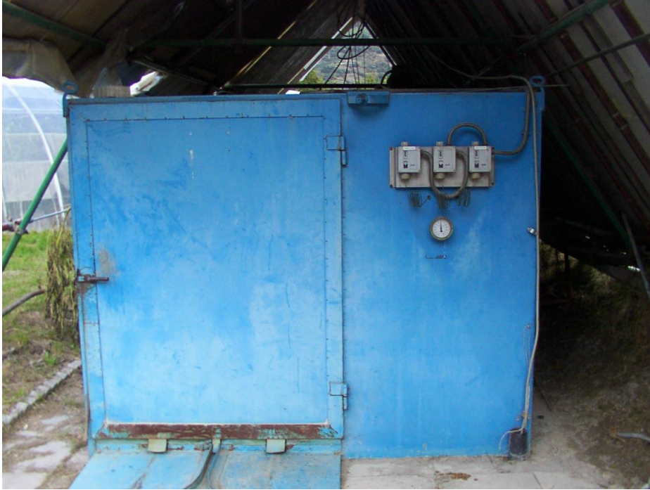
Le four à fruits : une porte devant, une autre derrière. A droite les commandes de régulations en température et de pression en gaz. La montée en température est telle que l'environnement immédiat du four est clément, même par temps de gelées fortes. Aussi, pendant mes gardes, je venais m'y réchauffer de temps à autre. Appréciable !
